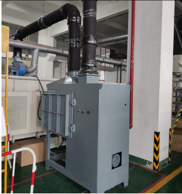
图 3-4 废气处理设施
