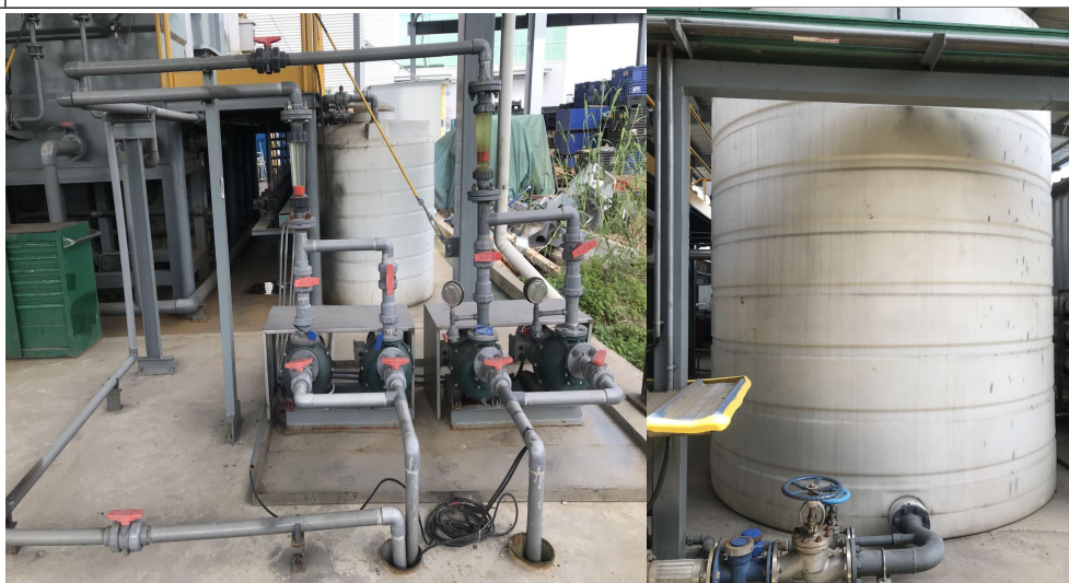
图 3-1 废水处理站进水口（左）、出水口（右）
