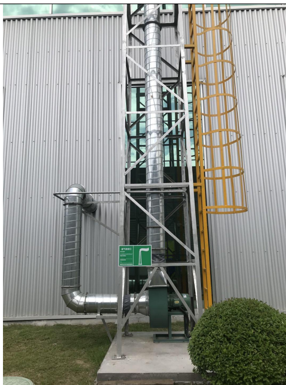
图 3-3 无机砂芯制芯废气处理设施图
