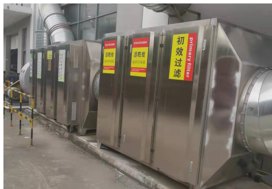
图 3-3 混料、浸胶、固化（G4、G5、G6 工序）废气处理装置
