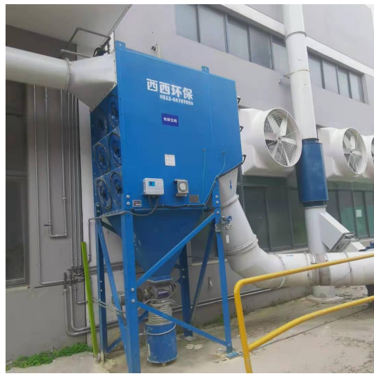
图 3-5 梯具锯切废气处理装置
