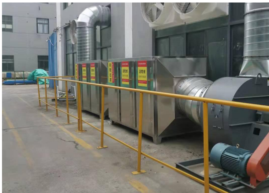
图 3-2 混料、浸胶、固化（G1、G2、G3 工序）废气处理装置
