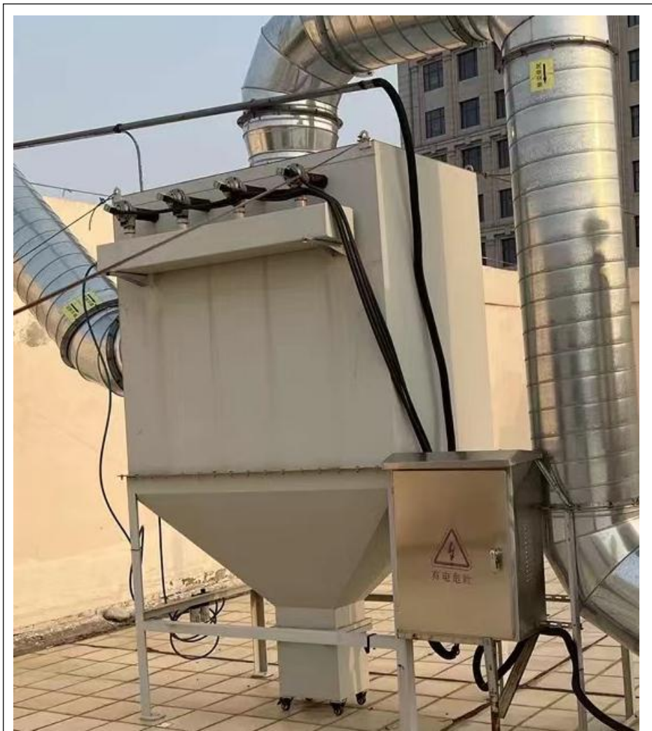
图 3-2 镭雕、焊接工序废气处理装置
