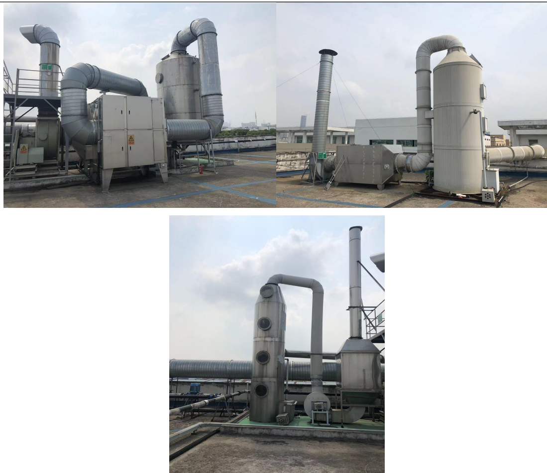
图 3-3 废气处理设施
