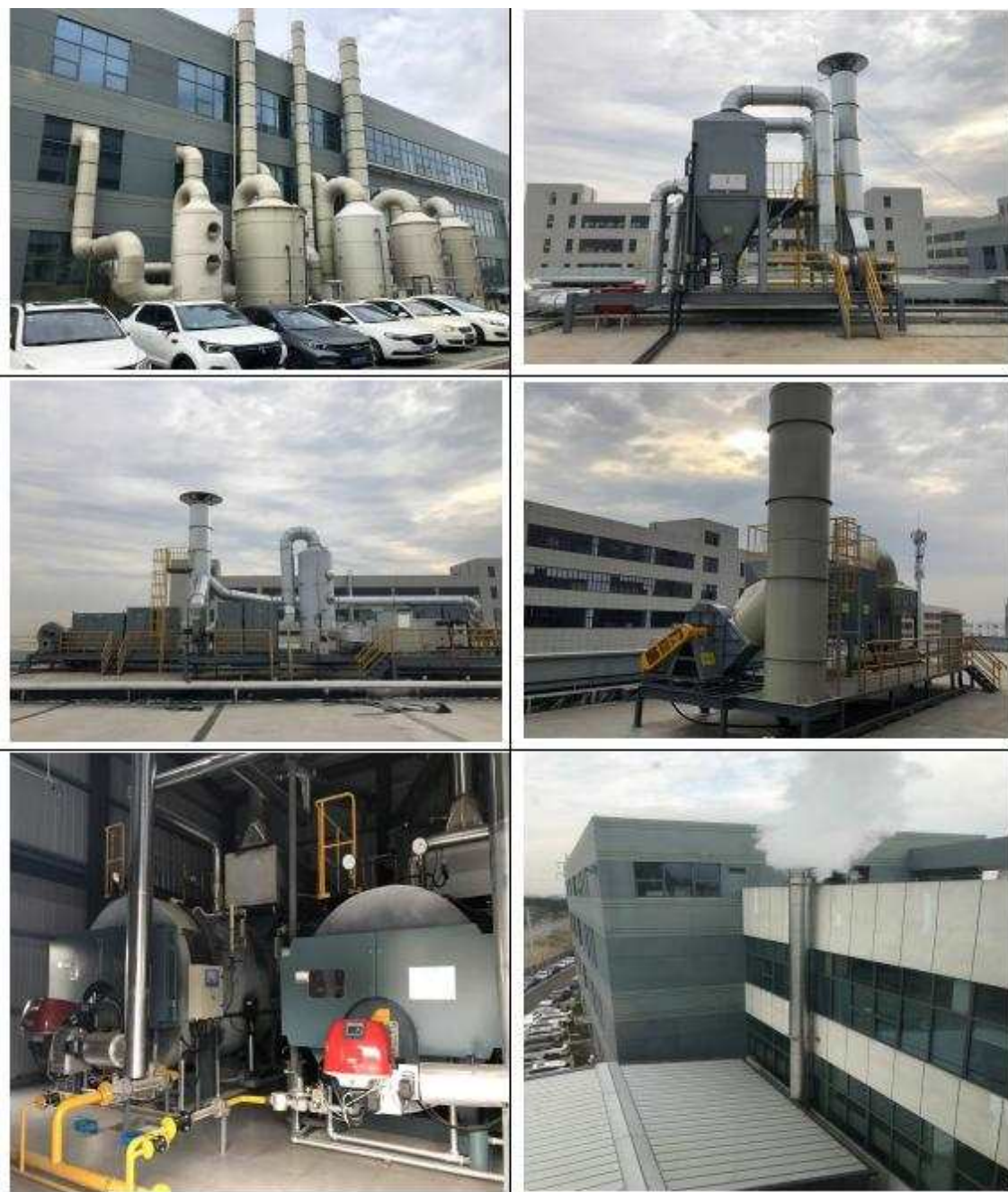
图 3-3 废气排放设施图
