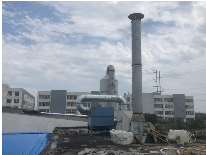
图 3-3 废气处理设施
