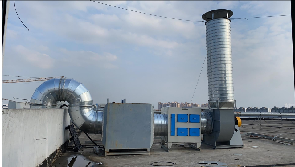
图 3-2 废气处理设施
