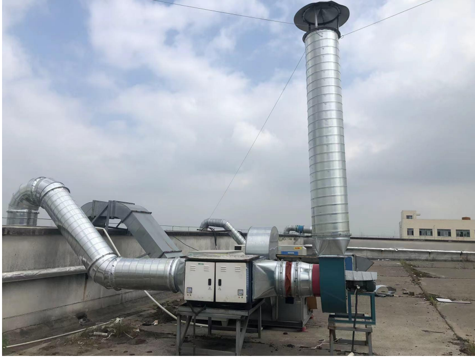
图 3-3 废气处理设施
