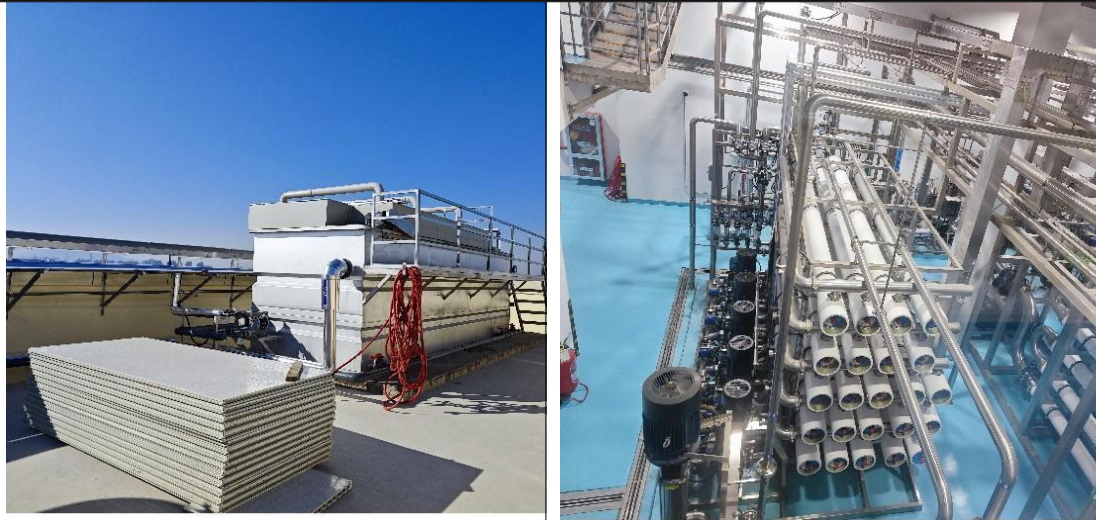
图 3-2 废水处理设施
