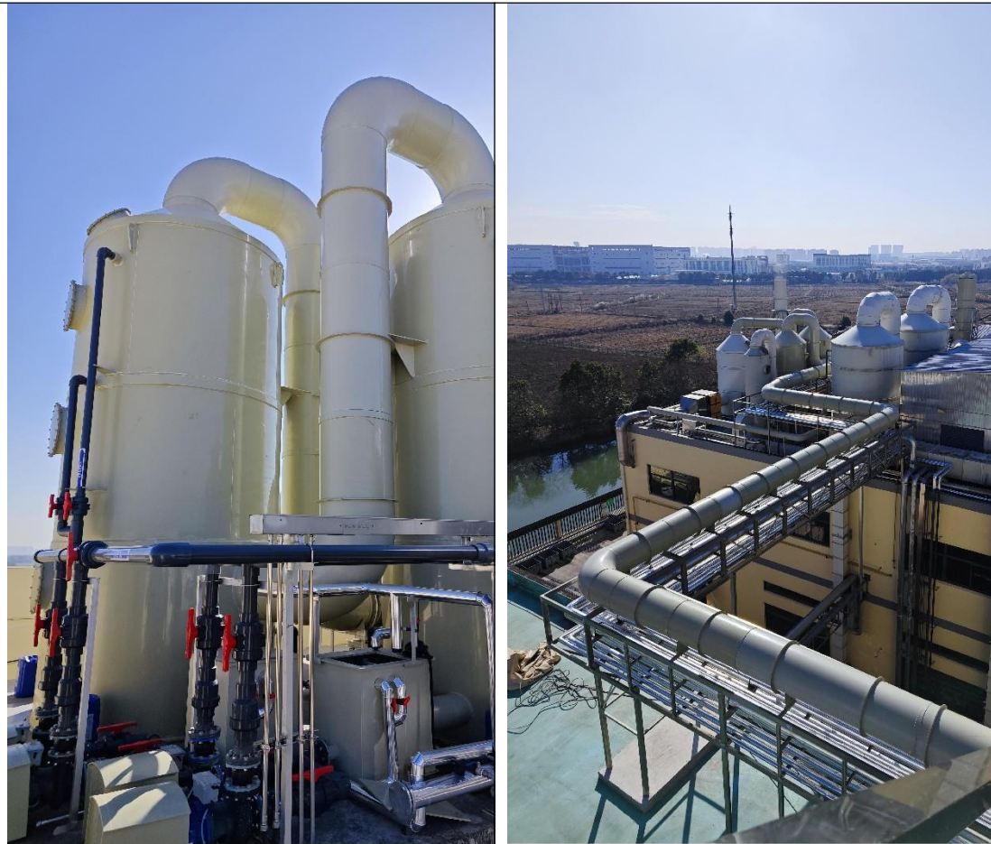
图 3-4 废气处理设施照片
