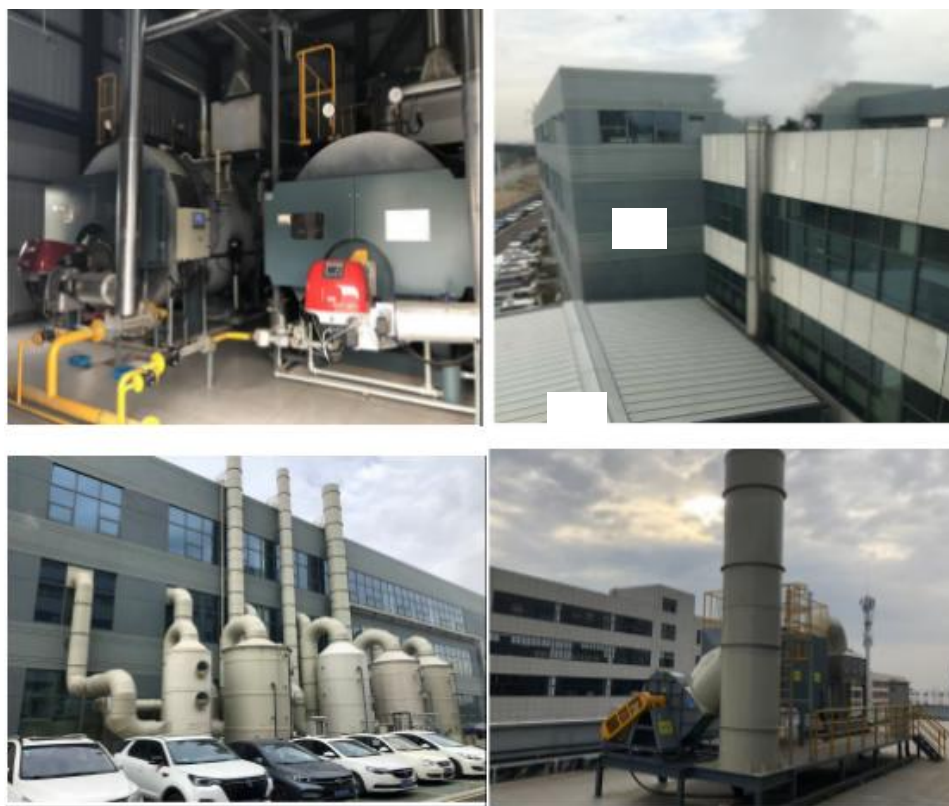
图 3-3 废气排放设施图
