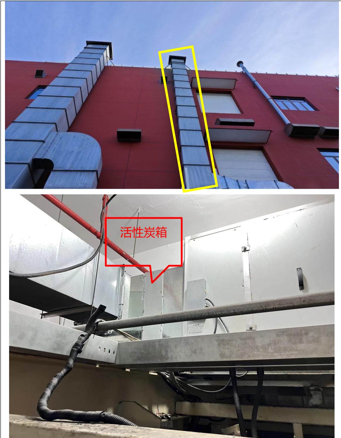
图 3-2 废气排放口及废气处理设施
